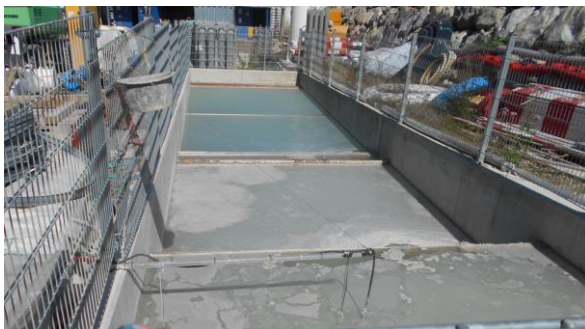
Installation de traitement des eaux – portail Nord : Bassin de décantation à plusieurs compartiments, avec sonde de mesure du pH au 1 er plan (B+C Ingénieurs, juillet 2019)
