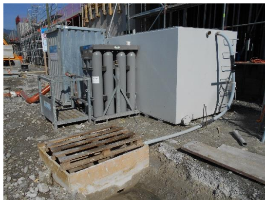
SER du lot 2, unité de traitement des eaux de la centrale à béton (Implenia), B+C Ingénieurs, mars 2017
